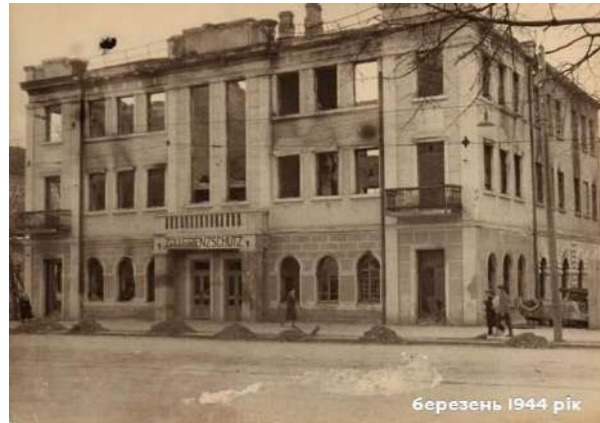
Рисунок 2.22 – Будівля після пожежі
