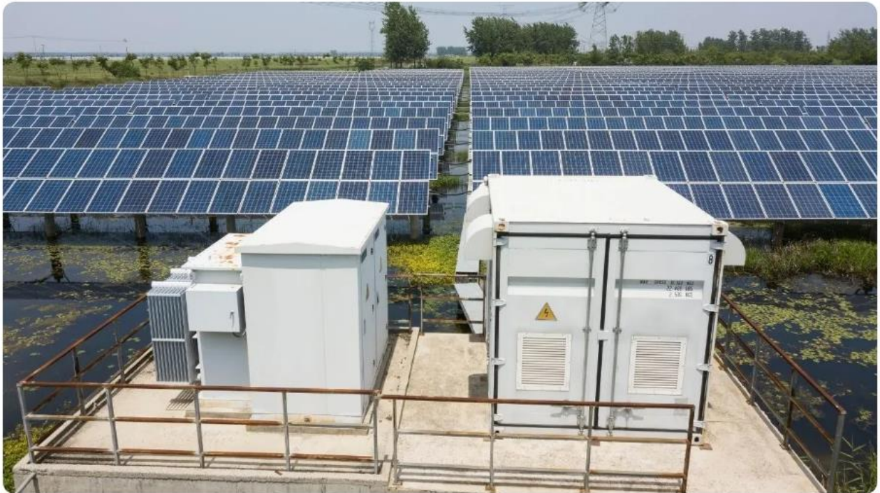
Рисунок 1.10 – Трансформатори на ФЕС
