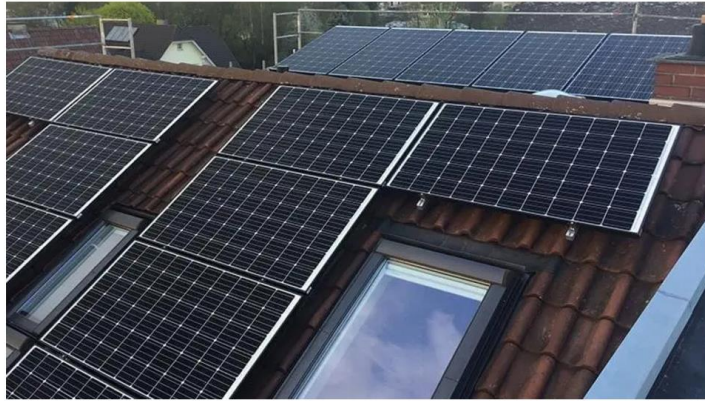
Рисунок 1.3 – ФЕМ встановлені на даху приватного будинку
