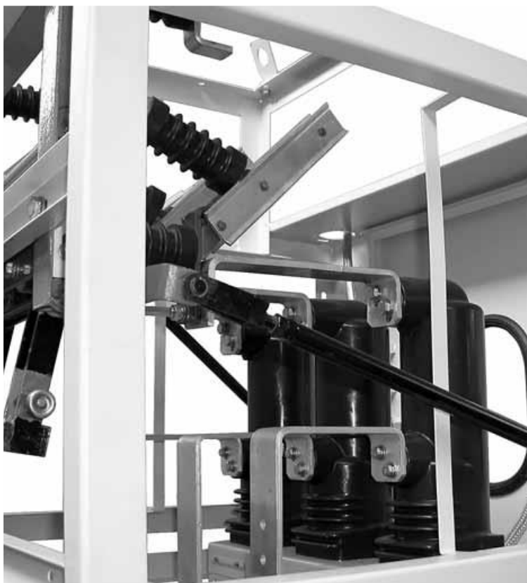
Рисунок 4.2 - Комплект монтажних частин з вимикачем ВР1, встановлений в КСО
