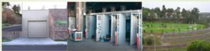
Підземна підстанція Park Above США [25]
