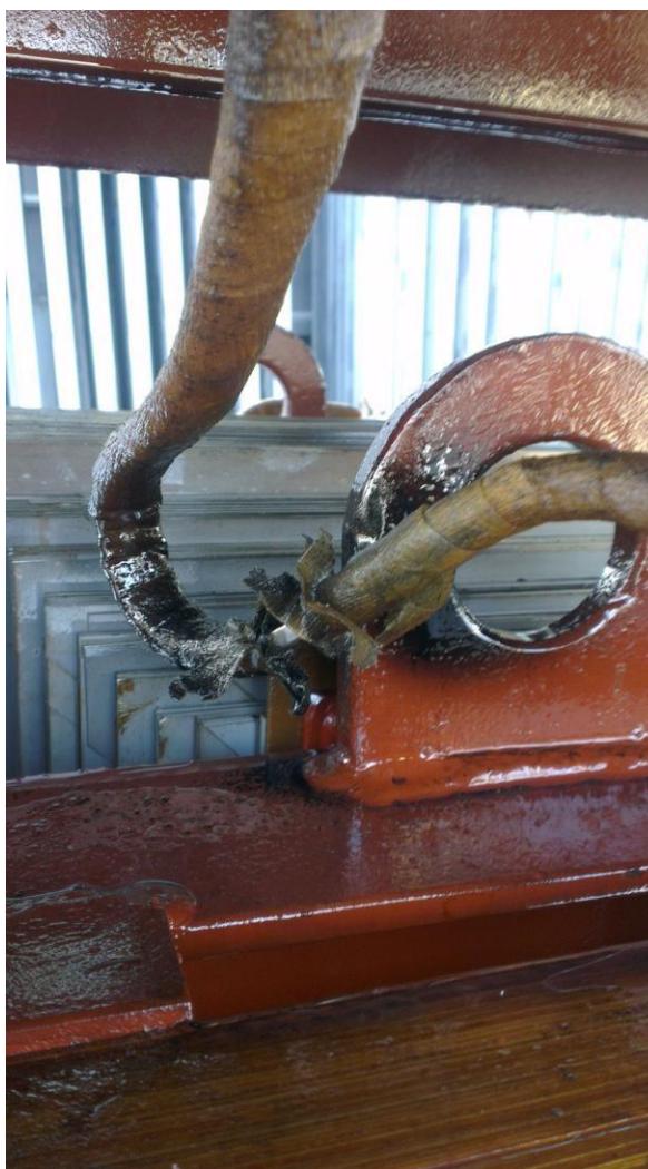
Рисунок 3.1 – Результати розкриття трансформатора ТМН-4000 35 кВ, пошкодженого дуговим розрядом
