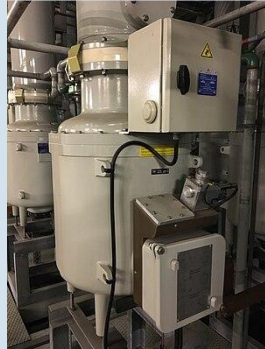
Трансформатор напруги 225 кВ/100В
