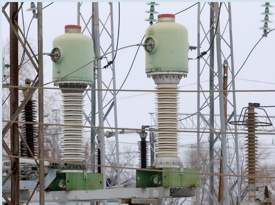
Елегазові трансформатори струму ТГФМ- 110
