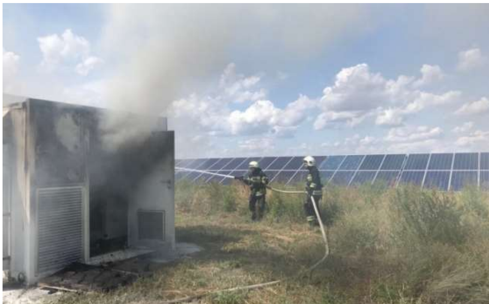
Рисунок 8.1 – Фото пожежі на сонячній електростанції з причини короткого замикання в електромережі
