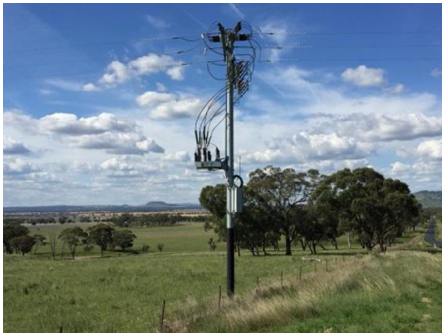
Рисунок 9.1 - Приклад розміщення реклоузера на проміжній опорі.
