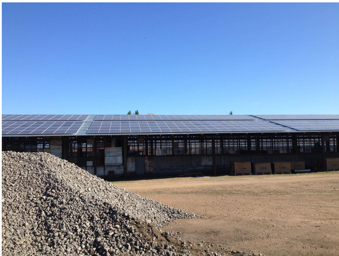
Рисунок 3.7 - Дахова сонячна електростанція
