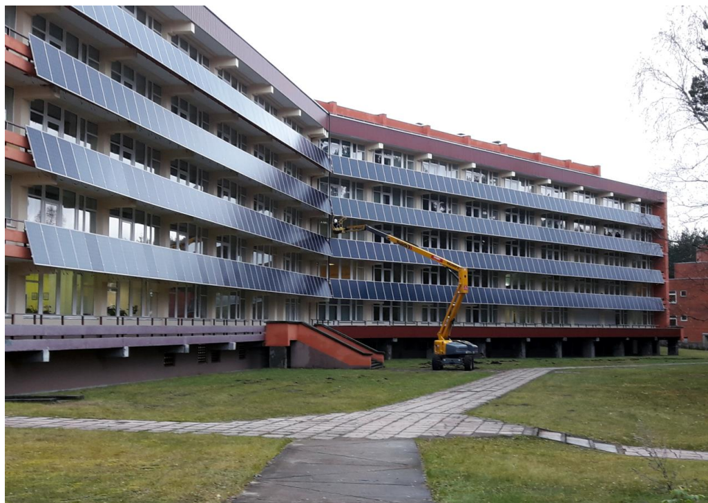
Рисунок 3.4 - Сонячна електростанція BIPV
