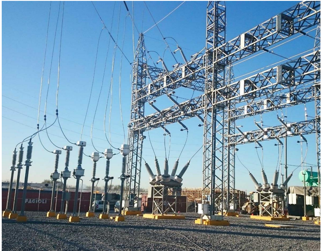
Рисунок 3.1 – Зображення електричної підстанції
