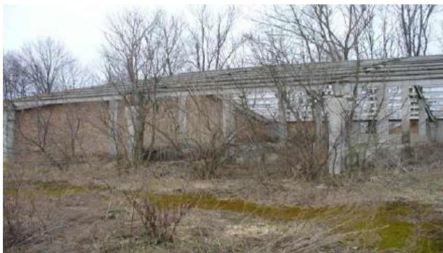
Рисунок 1.1 – Занедбаний склад отрутохімікатів (с.Ступник, Хмільницького району)
