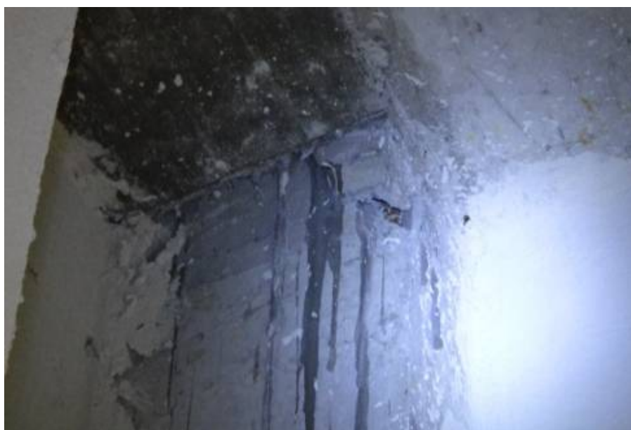
Рисунок 3.12 - Руйнування захисного шару бетону, корозія арматури
