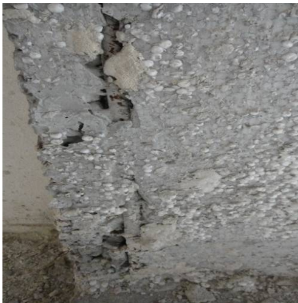
Рисунок 3.13 - Неякісне бетонування колони. Раковини у захисному шару бетону, оголення та корозія арматури
