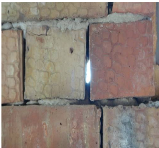
Рисунок 3.14 - Відсутність цементного розчину у швах цегляної кладки, недостатня перев'язка швів
