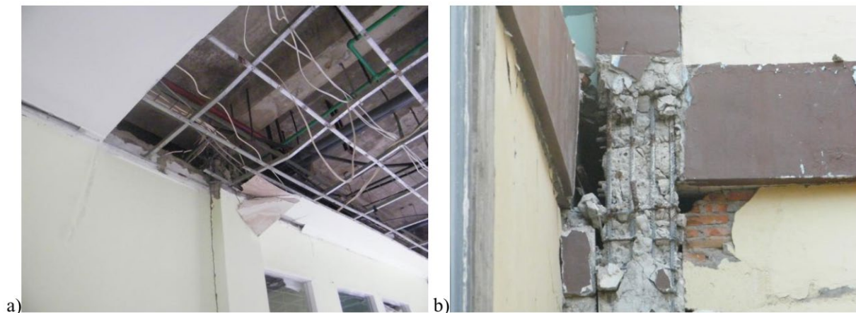
Рисунок 1.4 – Руйнування неармованої кладки із залізобетонним перекриттям: а - другий поверх із залізобетону;
