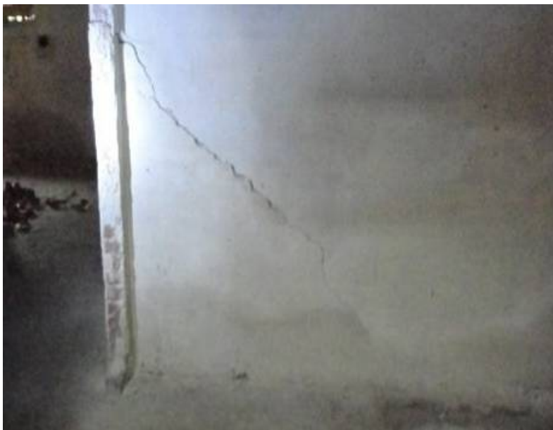
Рисунок 3.11 - Похила тріщина шириною розкриття до 20 мм в цегляній стіні підвального поверху
