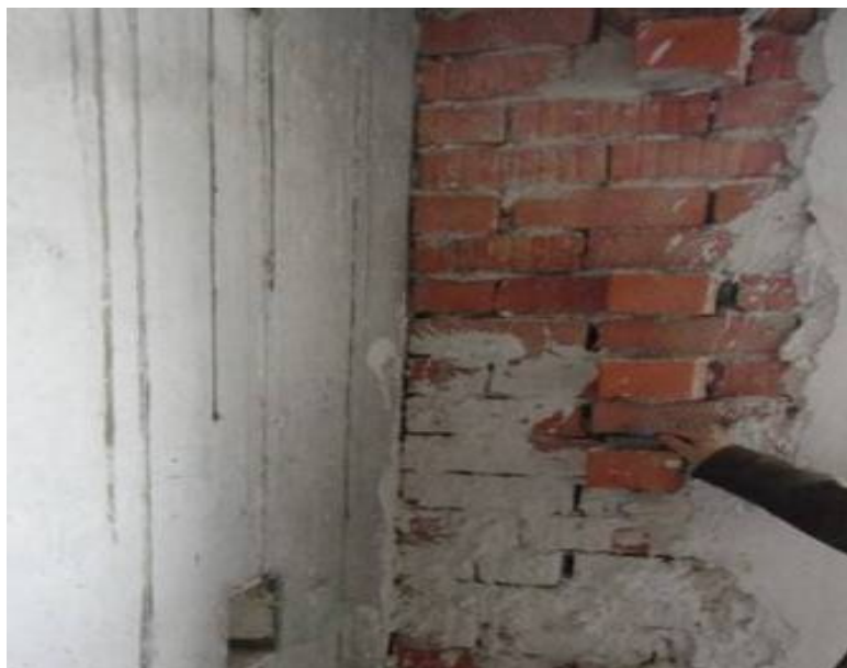
Рисунок 3.16 - Відсутність штукатурного оздоблення стін
