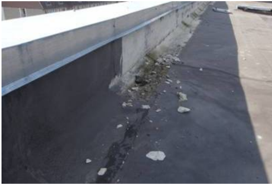
Рисунок 3.17 - Відсутність матеріалу гідроізоляції на покрівлі
