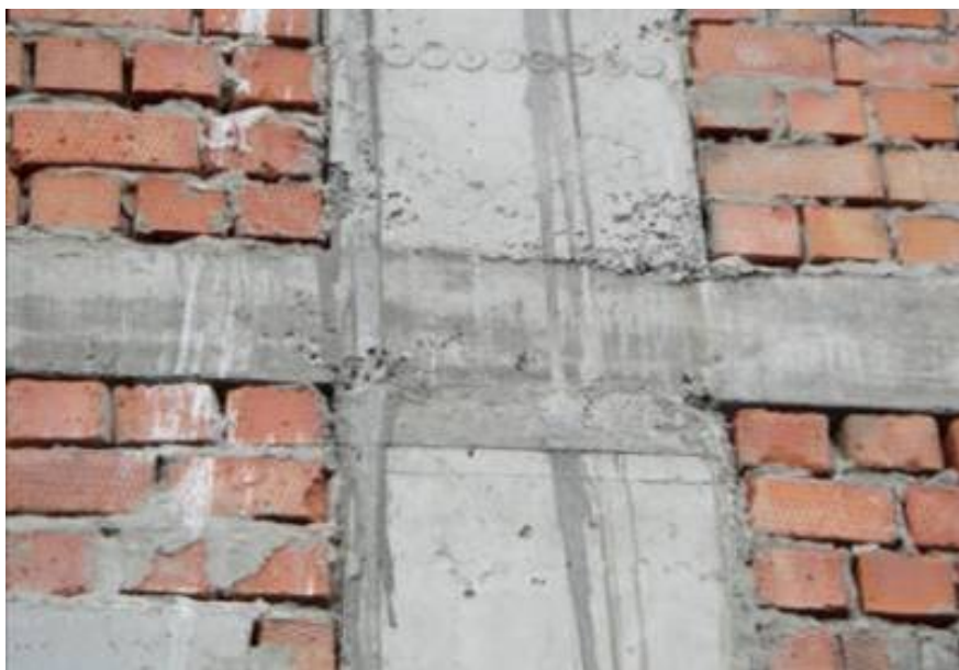
Рисунок 3.15 - Відсутність матеріалу заповнення між конструкціями каркасу та зовнішньою стіною
