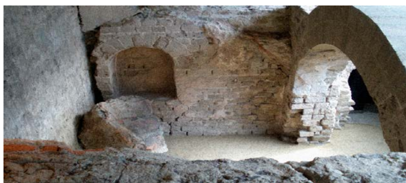
Рисунок 1.2 – Деформації та тріщини в основі споруди при осіданні ґрунтів
