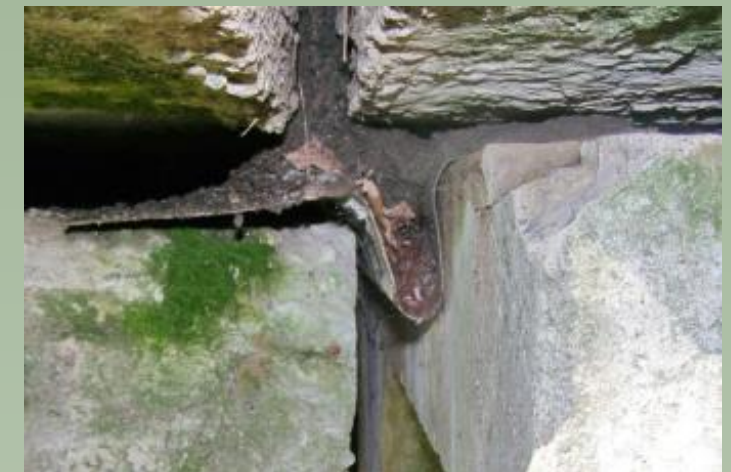
Рис. 4.6 – Загальний вигляд та стан деформаційного шва по осі «3»
