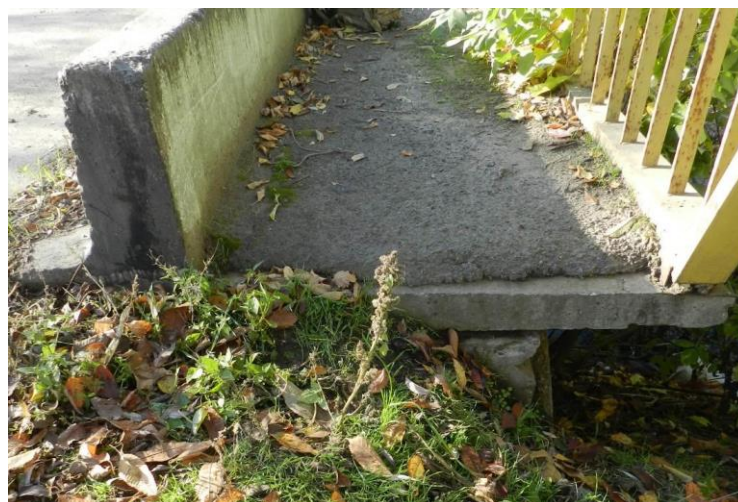
Рисунок 4.8 – Загальний вигляд тротуарної плити по осі «Б» поблизу осі «0» та загальний стан сполучення тротуарної частини мосту з підходами
