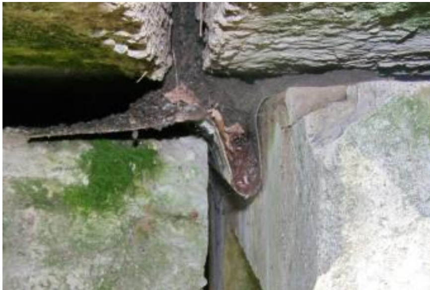
Рисунок 4.6 – Загальний вигляд та стан деформаційного шва по осі «3»
