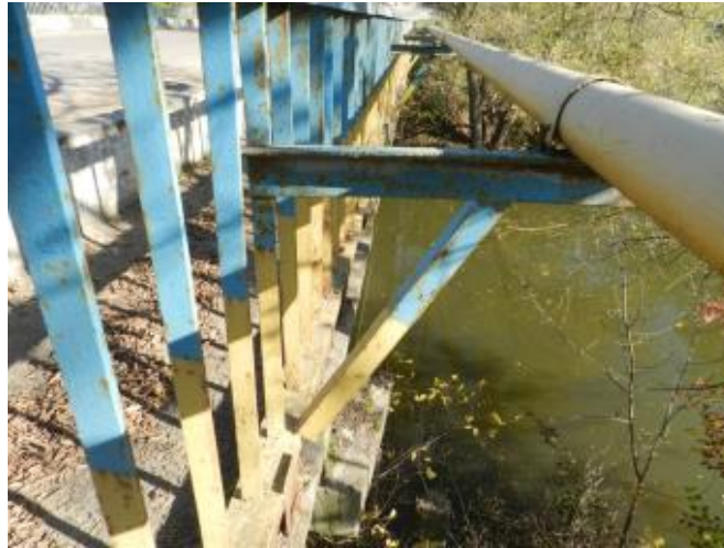
Рисунок 4.7 – Загальний вигляд та стан перильного огороження по осі «А» та труби газопроводу
