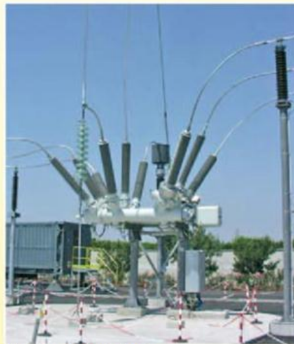
Прохідна підстанція, Італія
