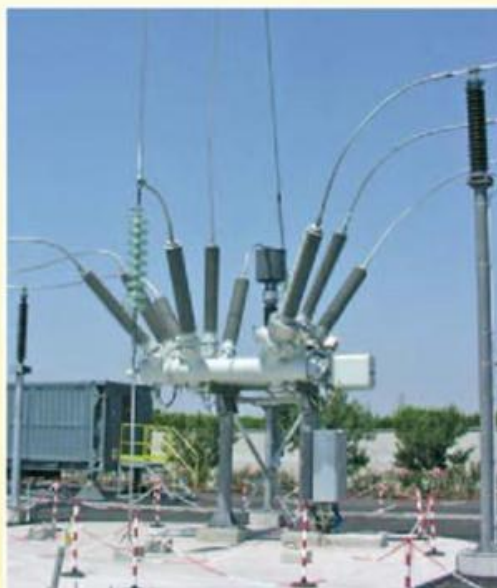
Прохідна підстанція, Італія
