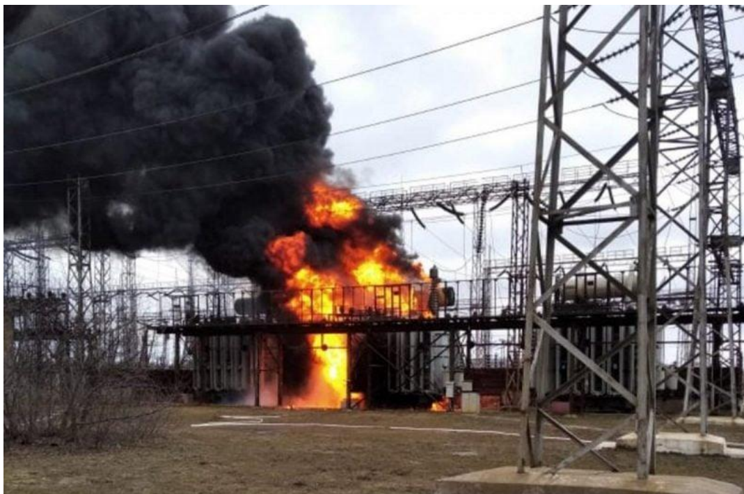
Рисунок 2.3-Пожежа на трансформаторі внаслідок аварійної ситуації
