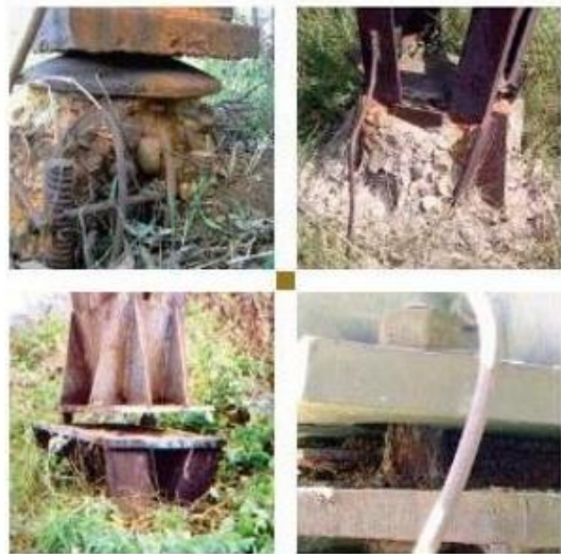
Рисунок 2 – Характерні руйнування фундаментів металевих опор
