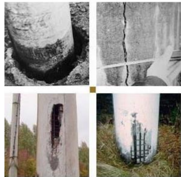
Рисунок 3 – Характерні руйнування залізобетонних опор
