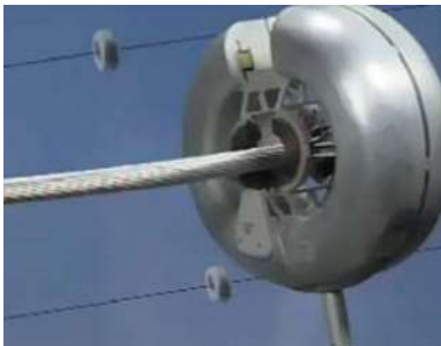
Рисунок 3.11 - Монтаж вимірювача Donut на проводі ЛЕП
