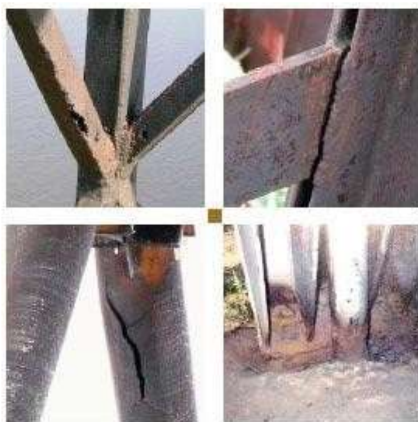
Рисунок 1.3 – Характерні руйнування металевих опор
