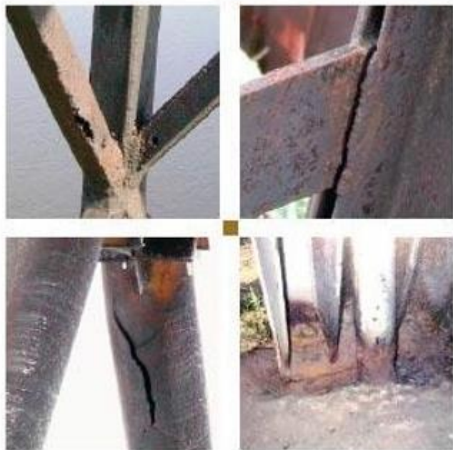
Рисунок 1 – Характерні руйнування металевих опор
