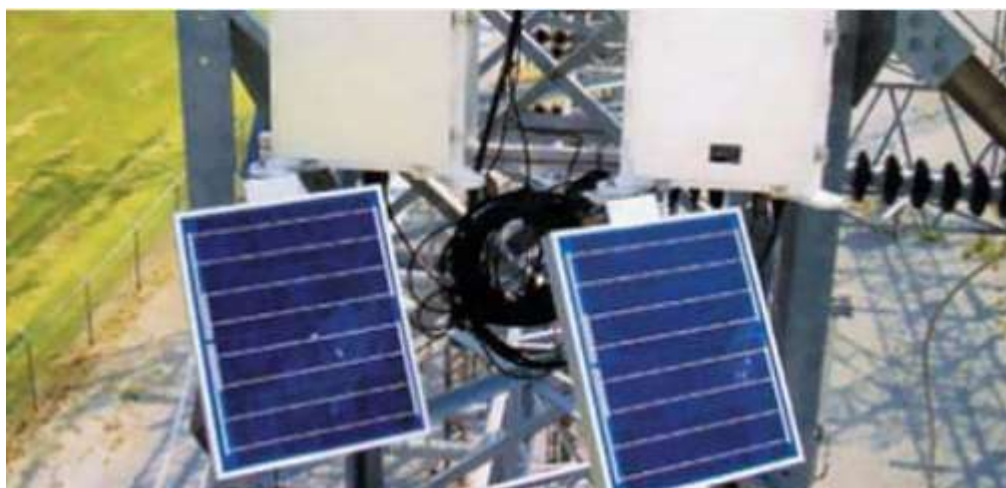
Рисунок 3.5 – Модуль живлення САТ-1. Вимірювальний модуль монтується на опорі
