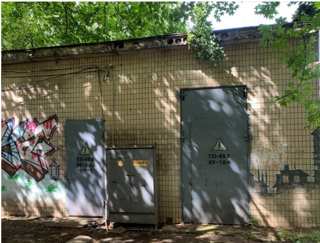
Зовнішній вигляд ТП 459, що розташована на території університету
