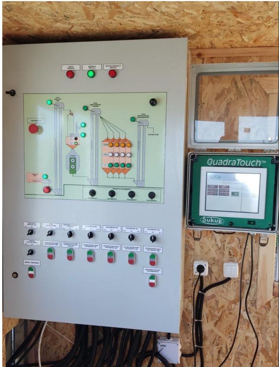
Рисунок 1.6 – Шафа керування в операторському приміщенні
