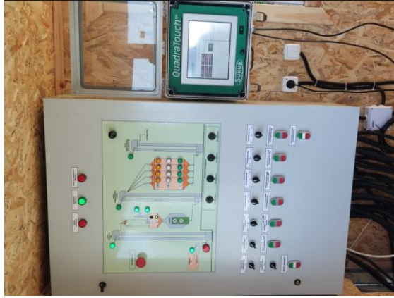
Щит керування в операторському приміщенні (до модернізації)
