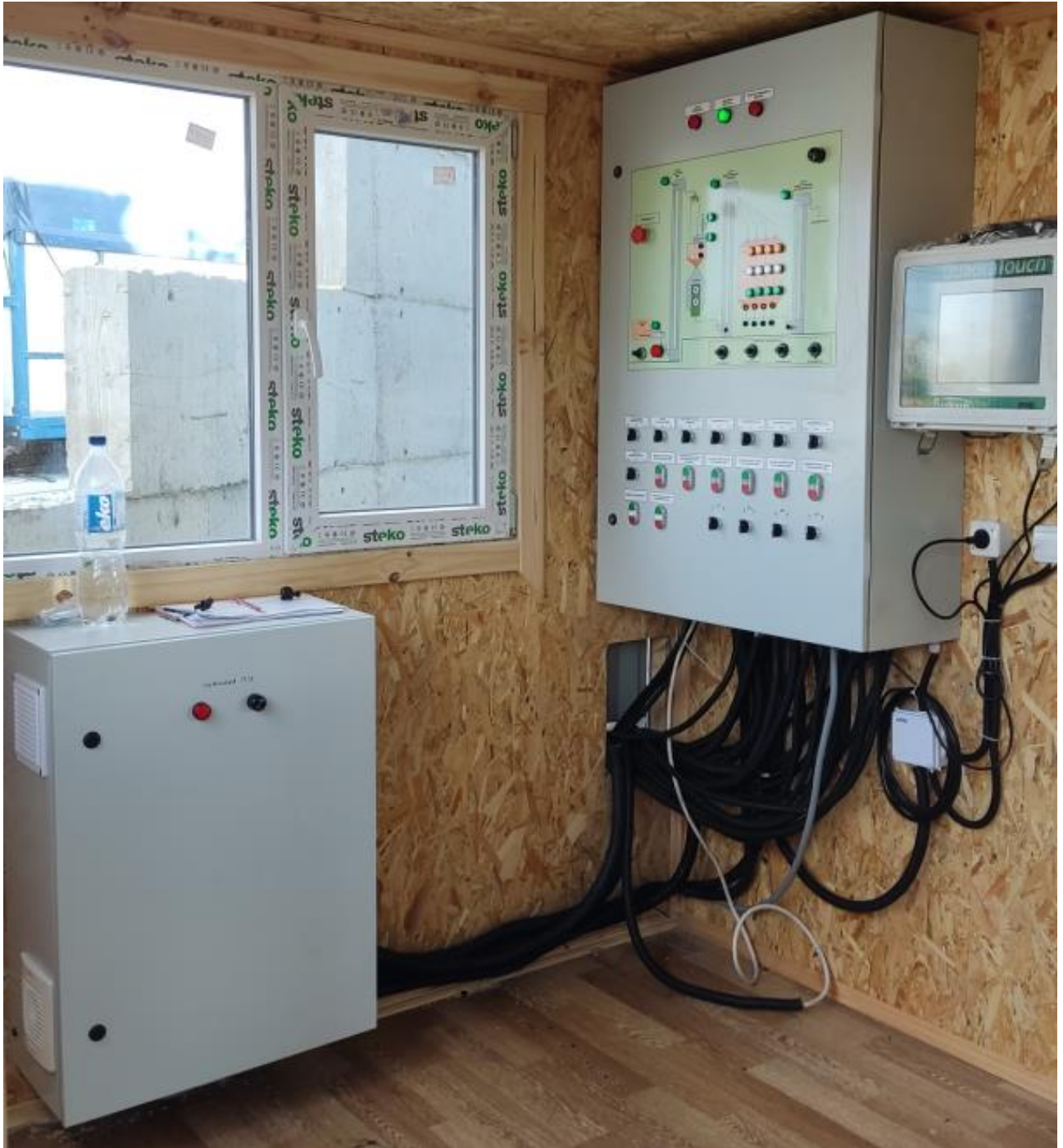
Рисунок 3.18 – Загальний вигляд операторського приміщення
