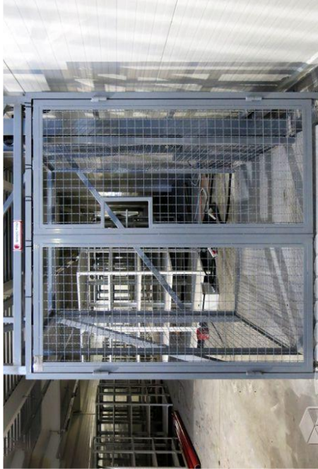
Зовнішній вигляд вантажного підйомника складського приміщення
