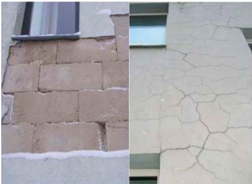
Рисунок 2.1 – Дефекти стін з неавтоклавного газобетону
