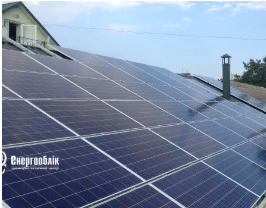
Рисунок 1.3 – Сонячна фотоелектрична станція
