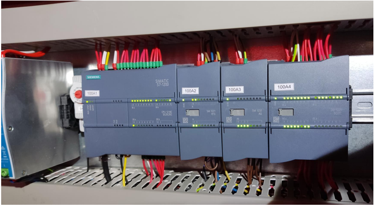
Рисунок 4.3 – Щит керування зерносушарки (контролер)
