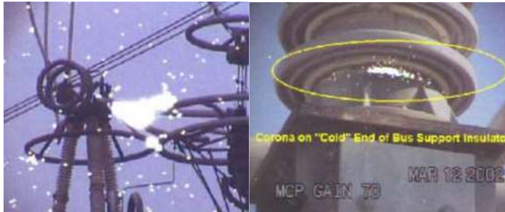
Рисунок 3.4 – Коронні розряди на дефектах в нижньому та верхньому небезпечних перерізах опорно-стрижневих ізоляторів та на ізоляційних конструкціях з ОСІ, виявлені за допомогою «DayCor 11»
