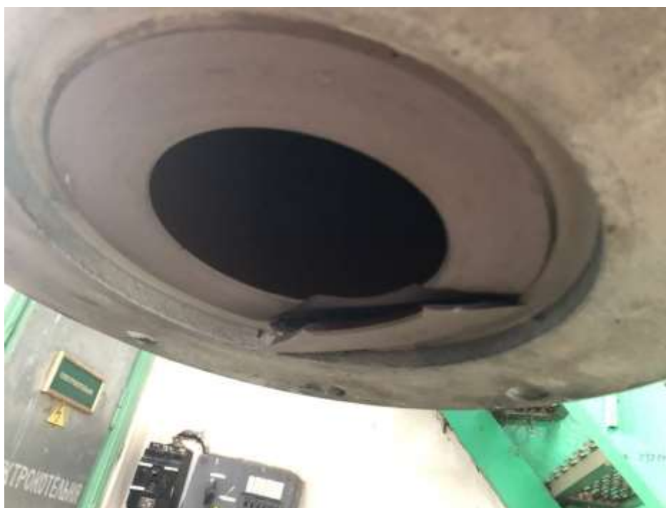
Рисунок 3.5 – Дефект опорного ізолятора елегазового вимикача
