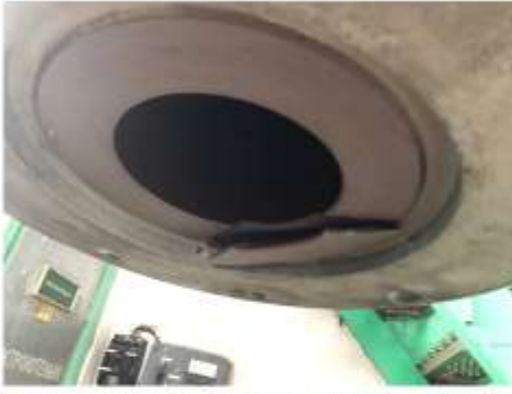
Рисунок 3.1 – Дефект опорного ізолятора елегазового вимикача
