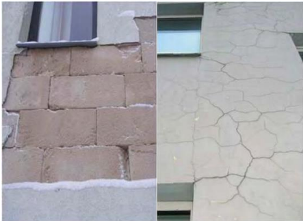
Рис. 6. Дефекти штукатурки, які виникають при порушенні вологісного режиму (відриви, тріщини)
