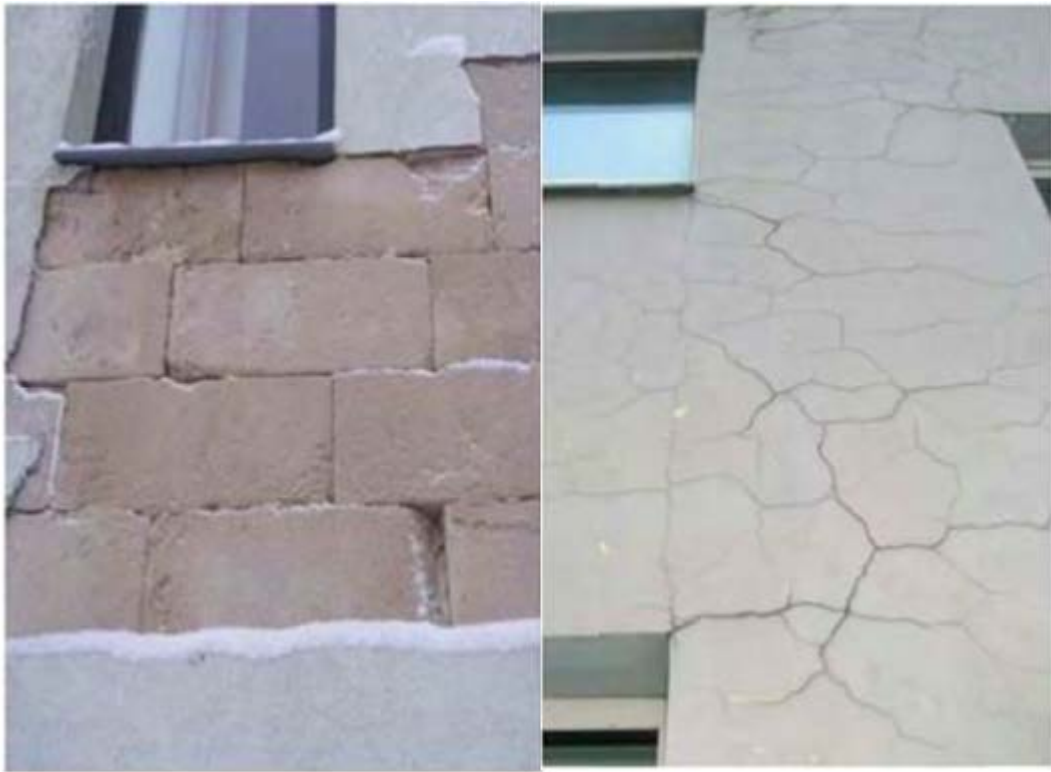
Рисунок 2.3 – Дефекти штукатурки, які виникають при порушенні вологісного режиму (відриви, тріщини)
