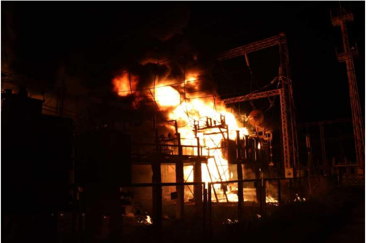
Рисунок 5.1 – Фото пожежі на трансформаторній підстанції з причини враження блискавкою
