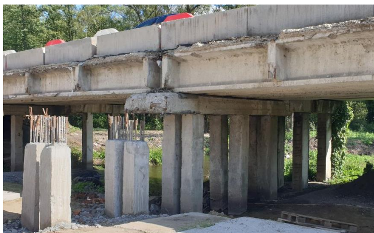
Рисунок 1.9 – Зовнішній вигляд та технічний стан деформаційного шва балочного мосту, збудованого у с. Пултівці.
