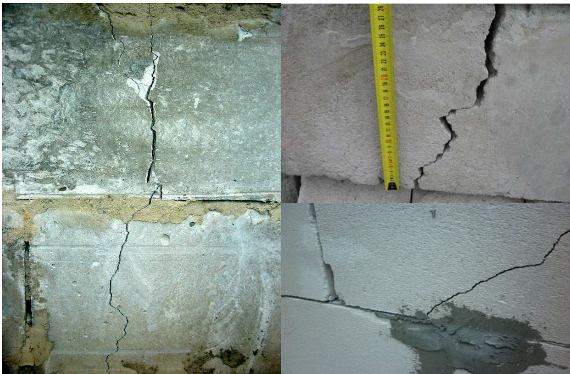
Рисунок 1.2 – Дефекти в кладці з піноблоків, викликані усадкою пінобетону
