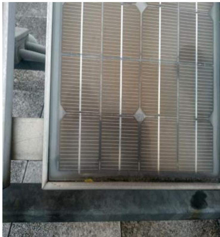
Рисунок В.11 – Пошкодження склопакету
