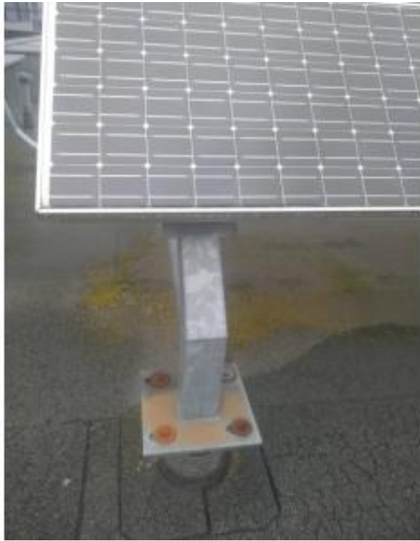
Рисунок В.10 – Пошкодження кріплення ФЕМ
