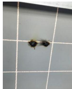
Пошкодження контактів в місці з'єднання cell з busbar
