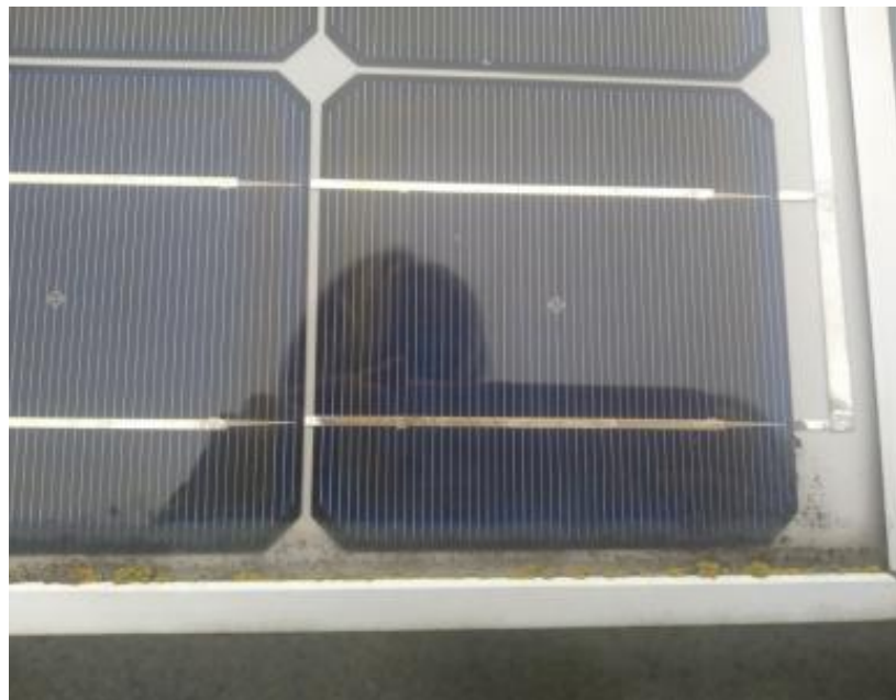
Рисунок В.9 – Пошкодження каркасу ФЕМ
