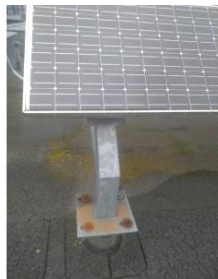
Пошкодження кріплення ФЕМ
