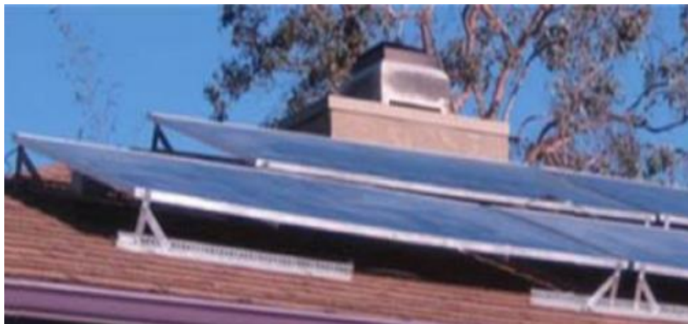
Рисунок В.13 – Значне вигинання каркасу ФЕМ через помилки монтажу
