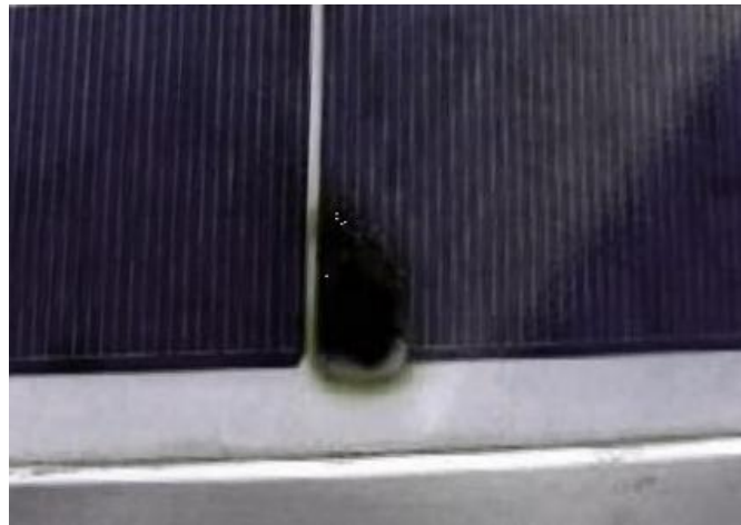
Рисунок В.3 – Дефект «Hotspot»
