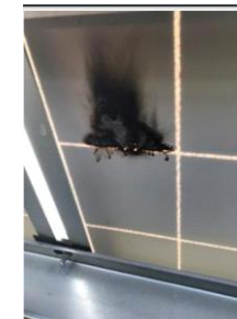
Пошкодження діоду Шоттки
