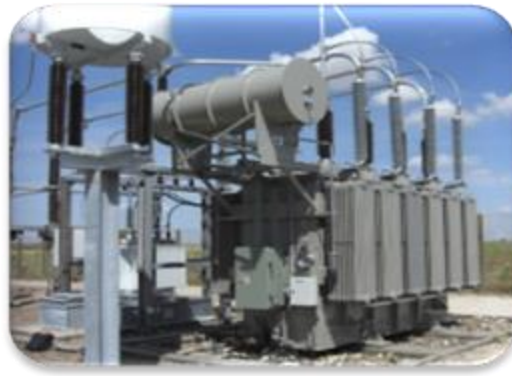
Рисунок 9.2 – Загальний вид трансформатора
