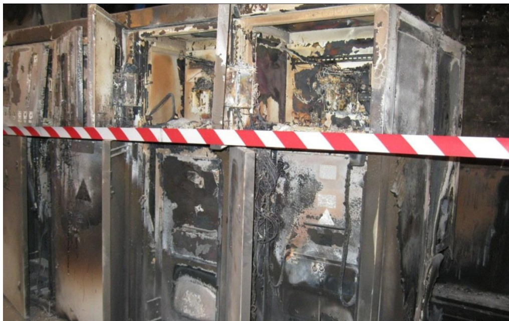
Рисунок 4.1 – Вакуумні коміркі після пожежі на трансформаторній підстанції
