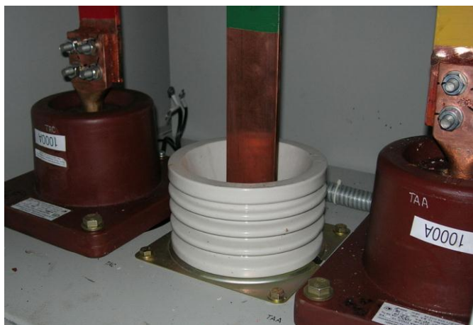
в – трансформатор струму в комірці КРУ-10 кВ
