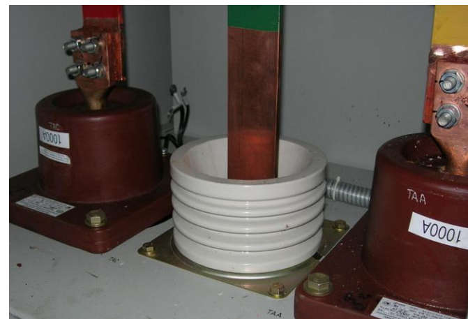
в – трансформатор струму в комірці КРУ-10 кВ
