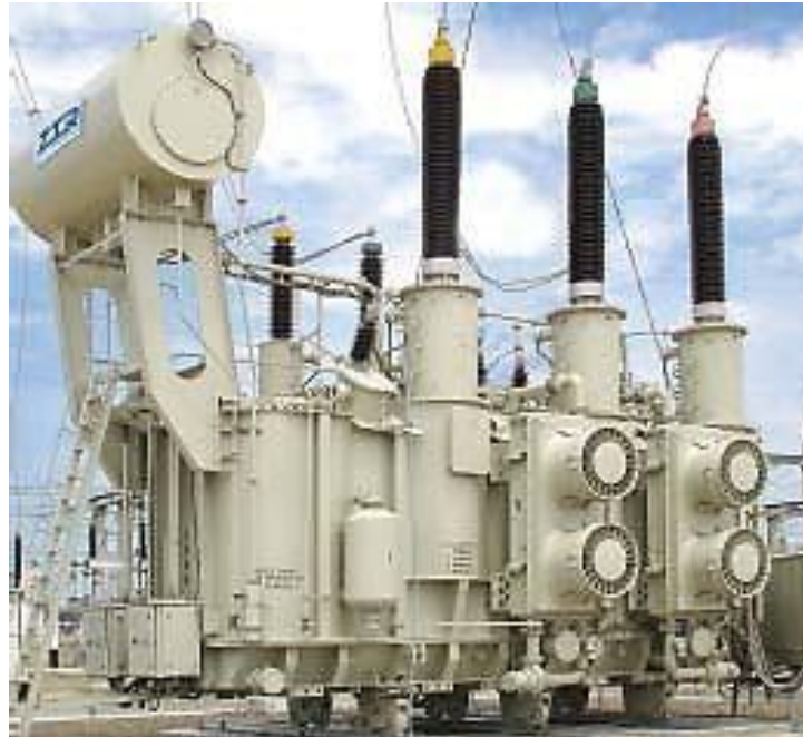
Рисунок 3.3 – Фото типового силового автотрансформатора
