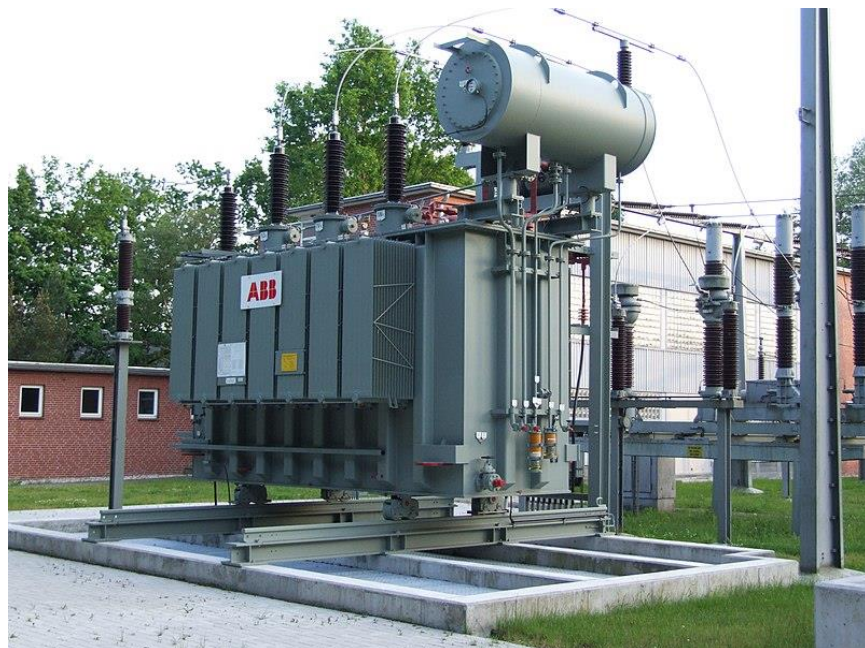
Рисунок 3.1 – Трифазний силовий трансформатор трансформаторної підстанції відкритого типу
