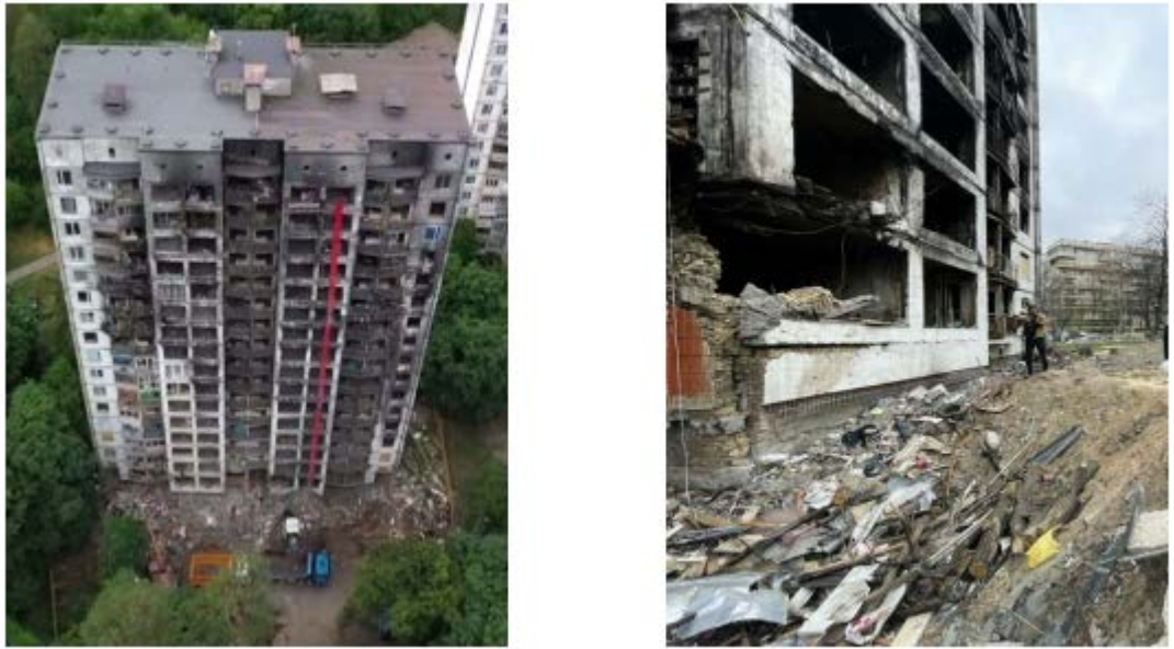
Рисунок 3.4 – Пошкодження багатоквартирного великопанельного будинку серії БПС по вулиці Чорнобильській, м. Київ
