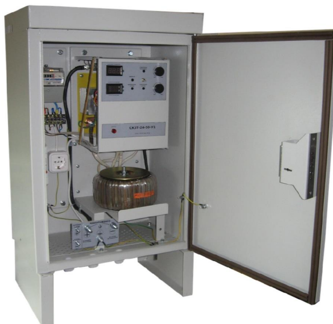
Рис. 3.5 – Зовнішній вигляд щита станції катодного захисту
