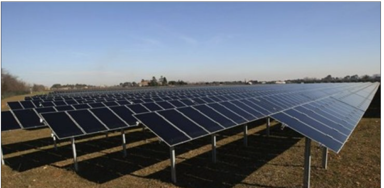
Рисунок 1.1 – «Слобода-Бушанська» фотоелектрична електростанція у Вінницькій області
