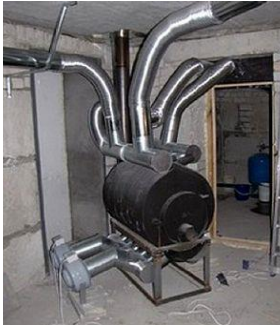
Рис. 1.7 – Повітрогенератор із повітропроводами
