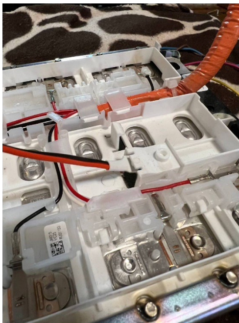
Рисунок 3.13 – Встановлення датчика температури
