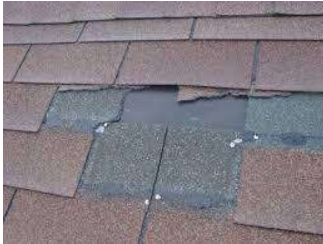
Рисунок 4.9 – Вигляд пошкоджене покриття даху
