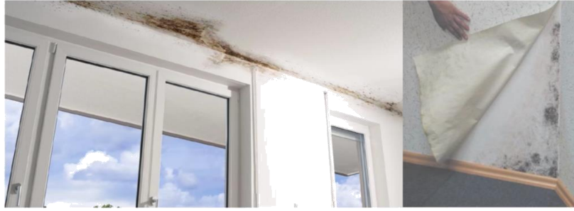
Рис. 3. 10 – Результат появи теплового моста у середині приміщення
