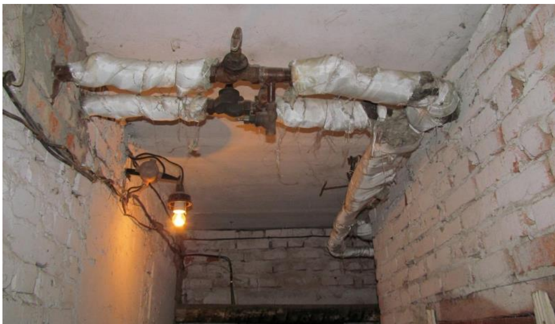
Рисунок 33- Технічний стан ізоляції труб у підвалі
