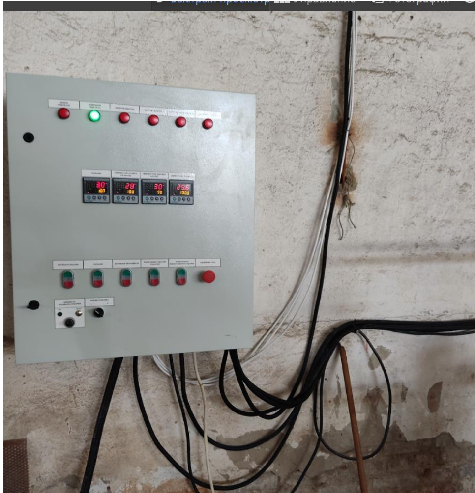
Рисунок 4.14 – Щит керування в реальних умовах експлуатації
