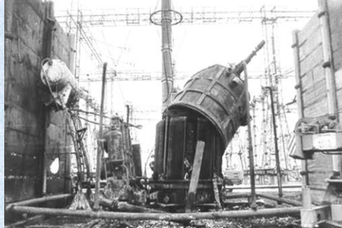
Рисунок 6.1 – Пошкоджений реактор 750 кВ
