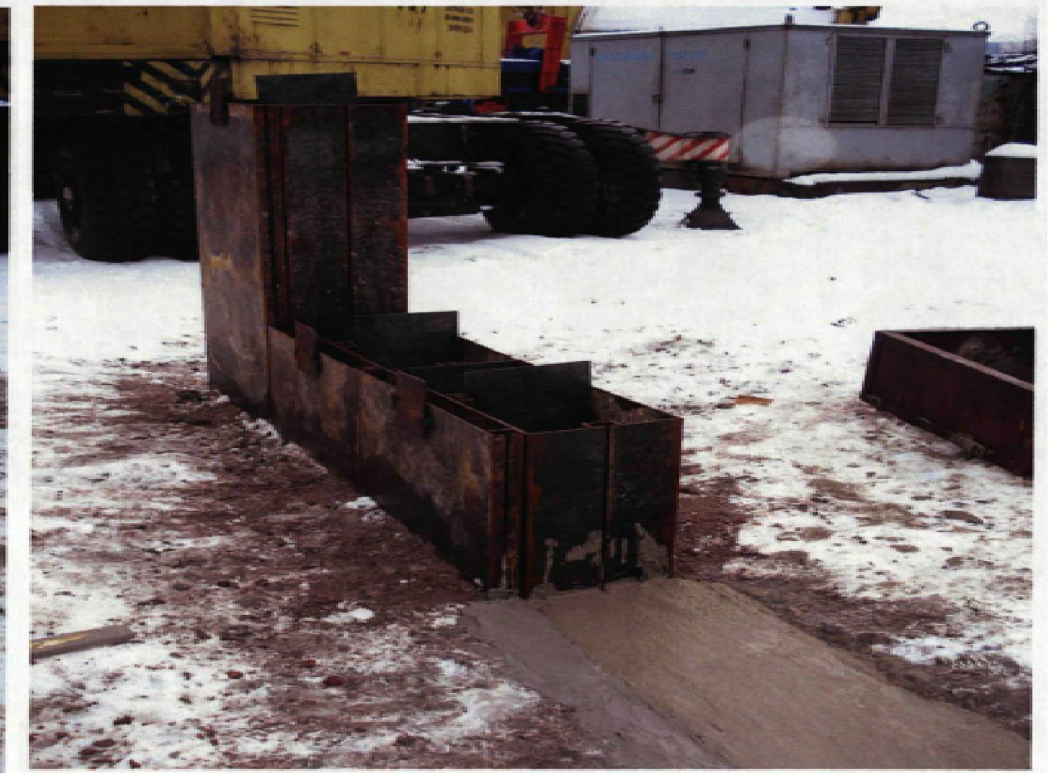
Рис.3. Опробування технологічних прийомів зведення «стіни в ґрунті» за вібраційною технологією (загальний вигляд).
