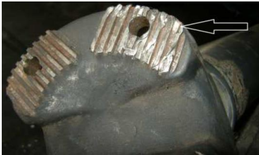
Рисунок 4.4 – Знос кріплення кордного валу
