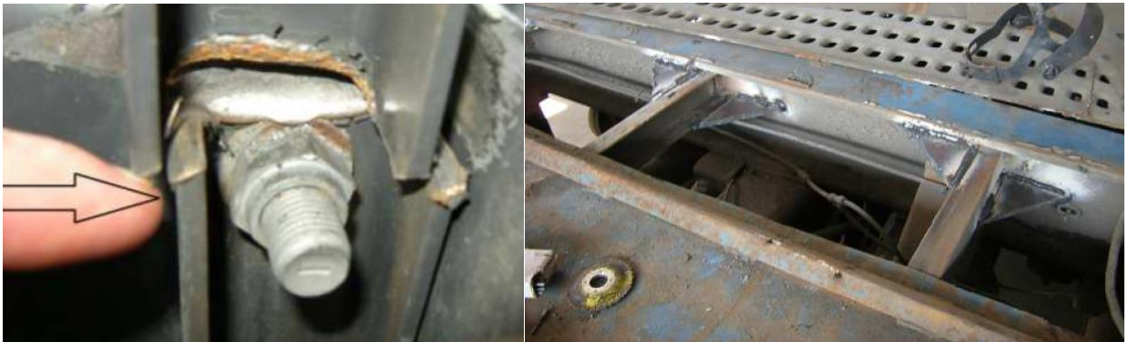
Рисунок 4.9 – Пошкодження стійки рами (зліва) та її посилення (справа)
