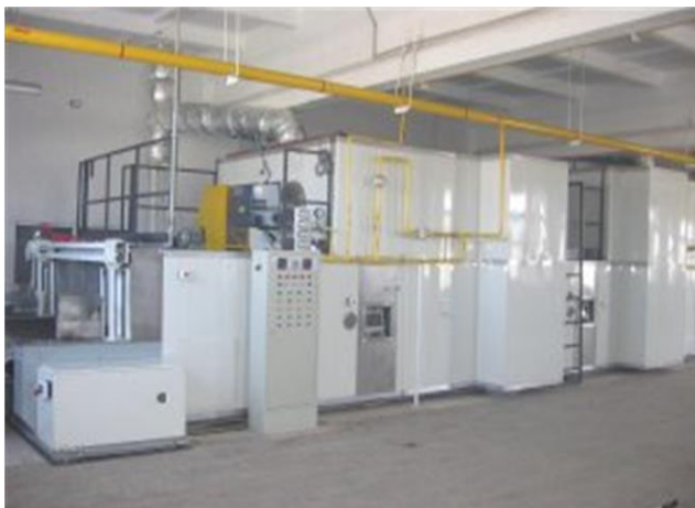
Рис.2.2. Зразок високотехнологічного обладнання на ПрАТ «Калинівський машинобудівний завод»
