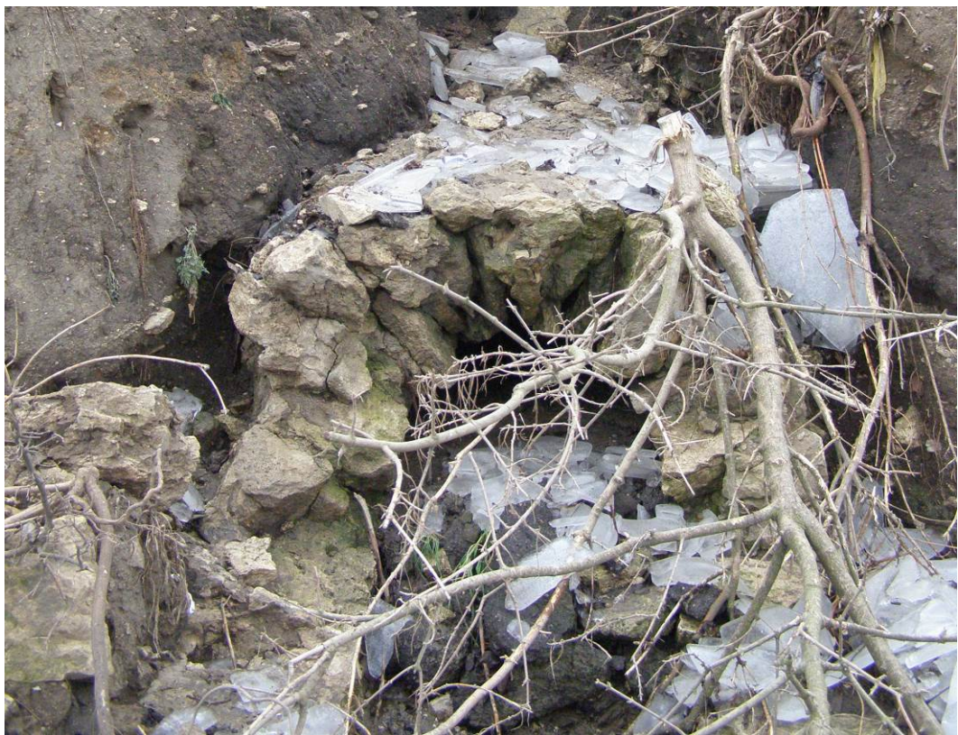
Рис. 2.3 – Вигляд та стан відповідного бутобетонного тунелю в місці скидання води. Схил розмитий водою. Тунель занесений ґрунтом до 90% перерізу,
