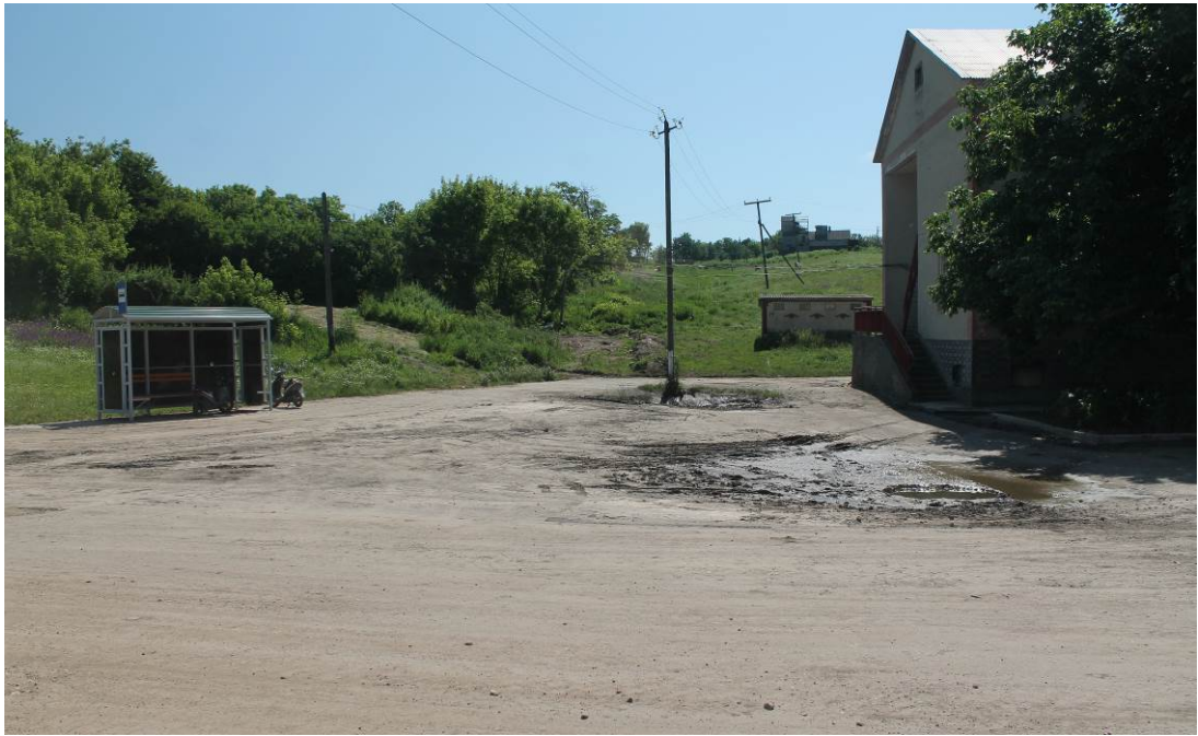
Рис. 2.2 – Загальний вид та стан створу обстежуваної ділянки. Вид із заходу. Сліди підтоплення території. Дощоприймальний колодязь №2 занесений ґрунтом.
