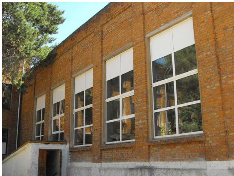
Рис. 1.7 Приклад найрозповсюджененого “містка холоду” у будівлях шкіль – наявність неізольованих залізобетонних перемичок
