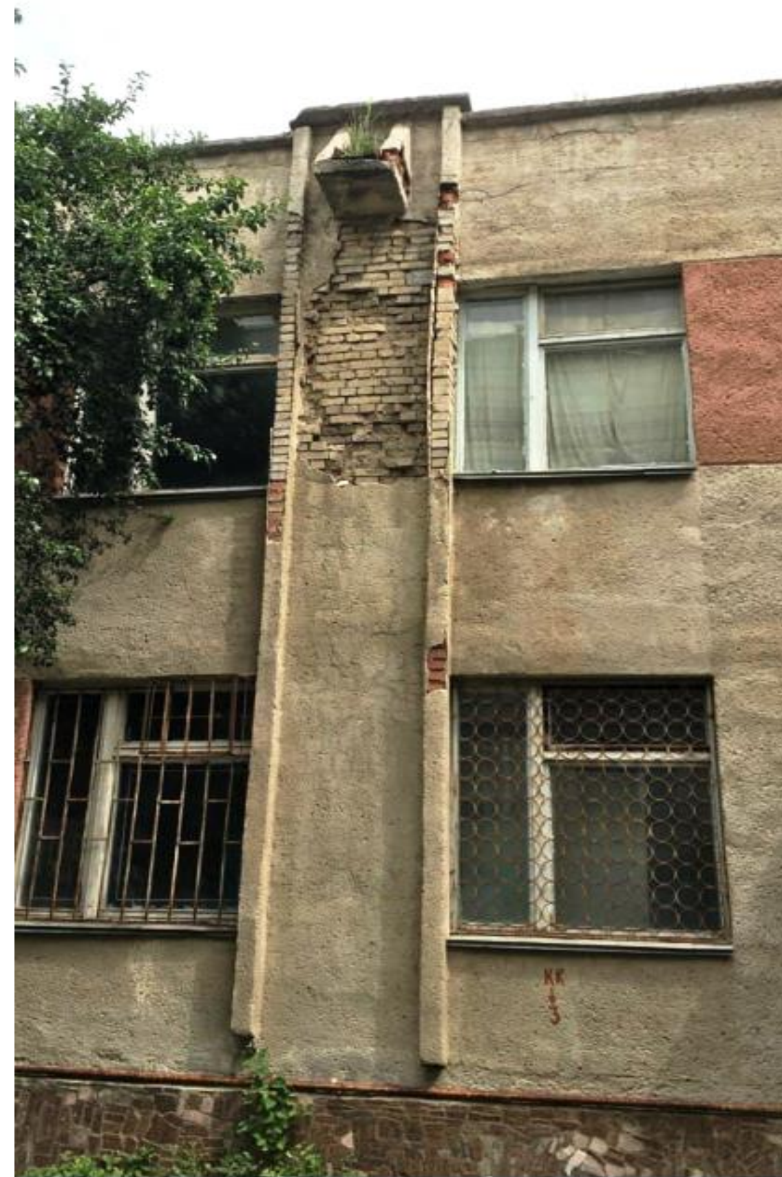
Руйнування конструкції стіни
