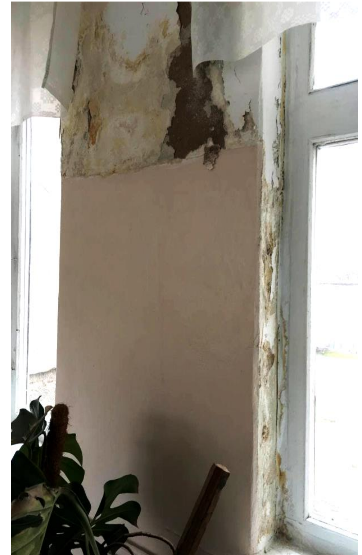
Відшарування штукатурки та поява плісняви
