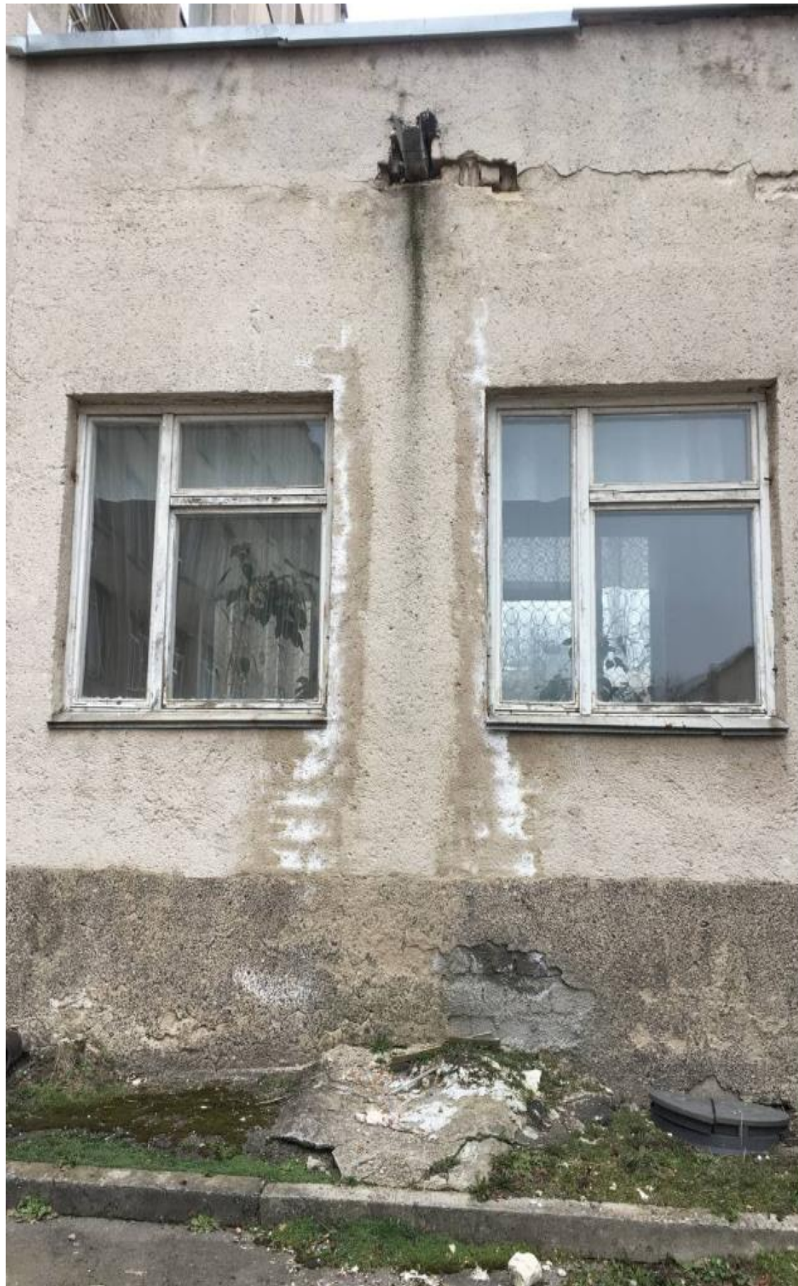
Замокання конструкції стіни
